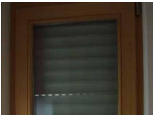
Rys. 4-2. Widoczny (niedopuszczalny) prześwit 10
