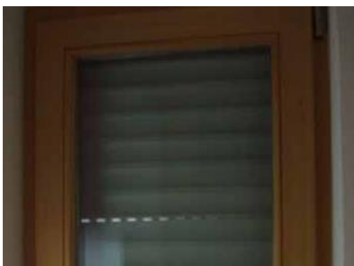
Rys. 6-2. Widoczny (niedopuszczalny) prześwit 14
